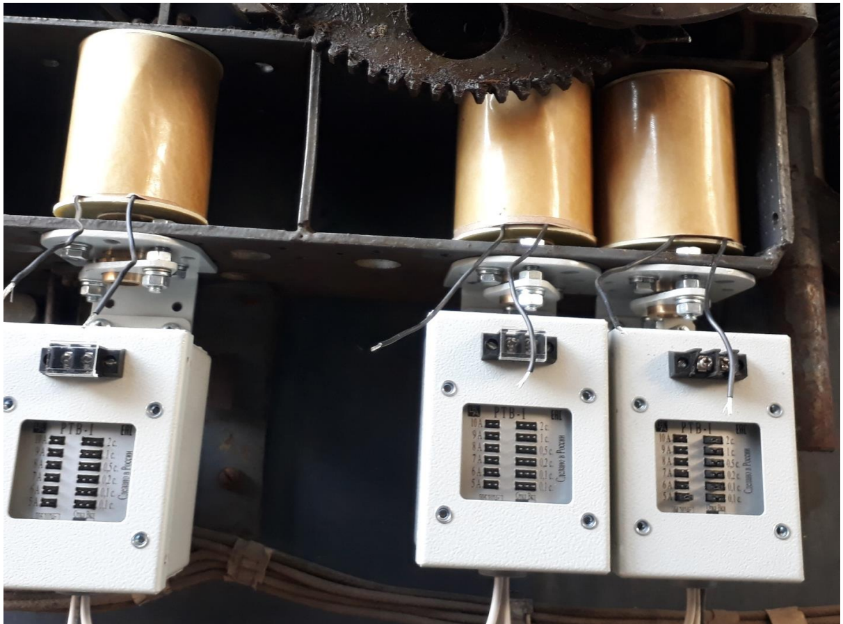
Рис. 21. Общее фото с тремя установленными РТВ-1 на пружинный привод ПП-67.
