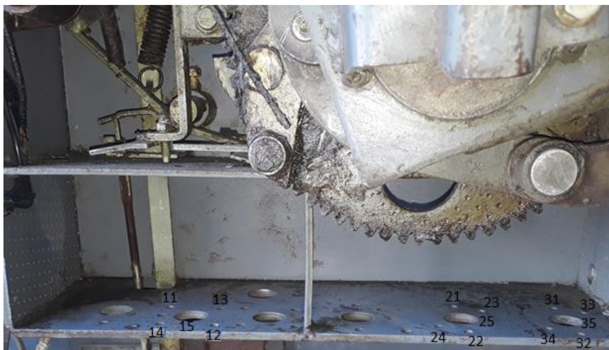
Рис. 11. Посадочные места реле РТВ-1 на конструктиве пружинного привода ПП-67. Вид сверху.
